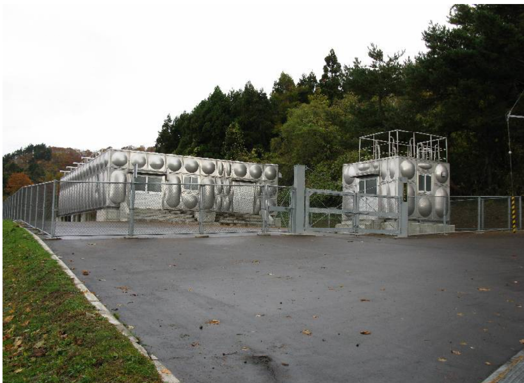
藤城第3配水池全景
